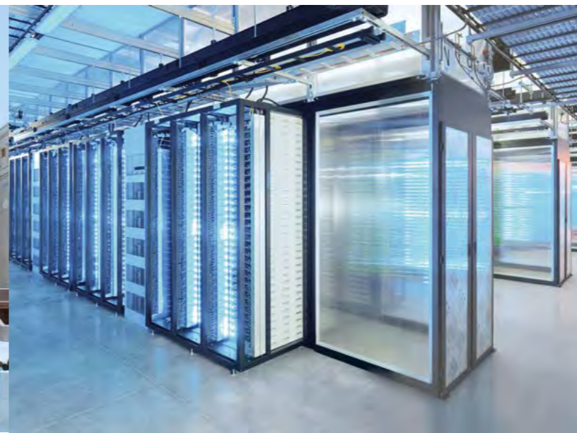
Humidificación y refrigeración evaporativa en el centro de procesamiento de datos de Meta (Facebook) en Luleå, Suecia
